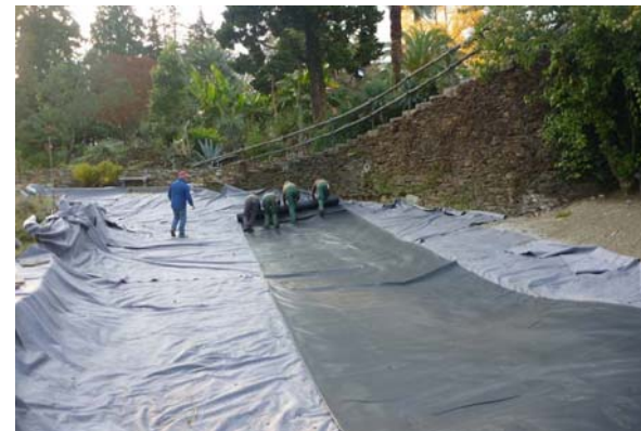
Abb. 3: Zum Schutz der Folie wurde zuerst ein Schutzvlies ausgelegt. Darüber wird nun die wasserdichte Teichfolie ausgerollt. Foto: Luca Bacciarini
